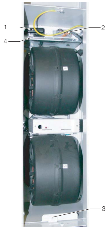
Abb. 34: Lüftermodul in der Maßerweiterung
